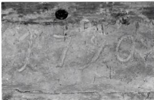
Die Jahreszahl 1790 befindet sich auf dem Hausboden über einen Türbogen. In dem Jahr soll der Dachstuhl des Hauses erneuert worden sein.
